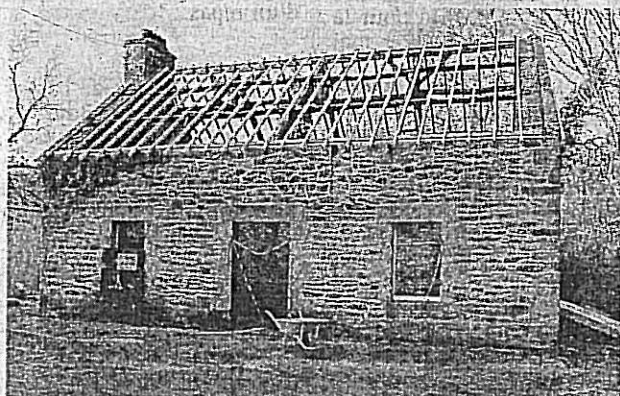
Le toit de l'ancienne crêperie a été déposé. Il sera recouvert cet hiver.
